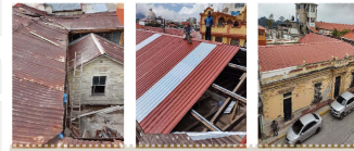
En las tres imágenes de fuente propia se observa el proceso de cambio de cubierta, manteniendo la quinta fachada y utilizando materiales igual a los originales.
